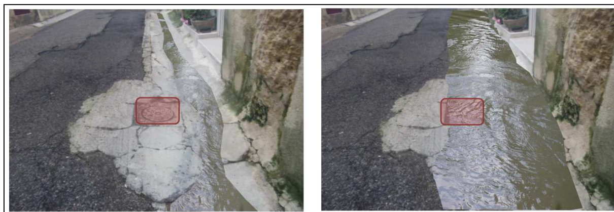
Exemple d'intrusion d'eaux claires parasites pluviales
