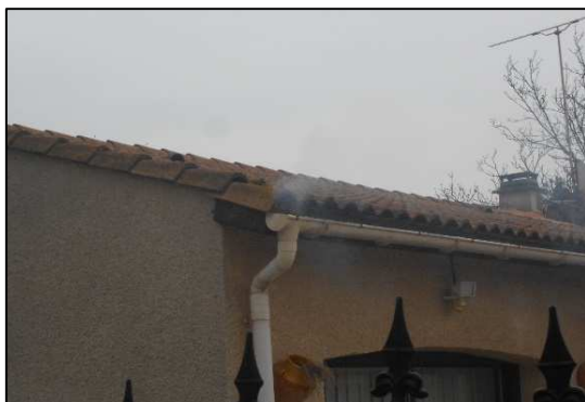
Anomalie sur une gouttière
