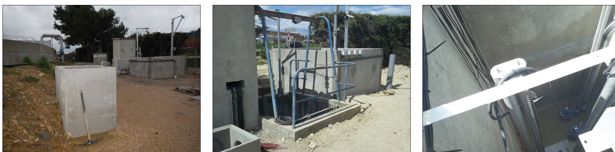
Poste de relevage et bassin d'orage ancienne station d'épuration Calvisson
