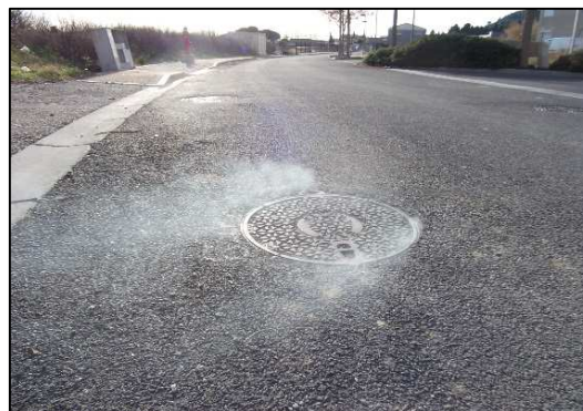
Anomalie sur un regard de visite
